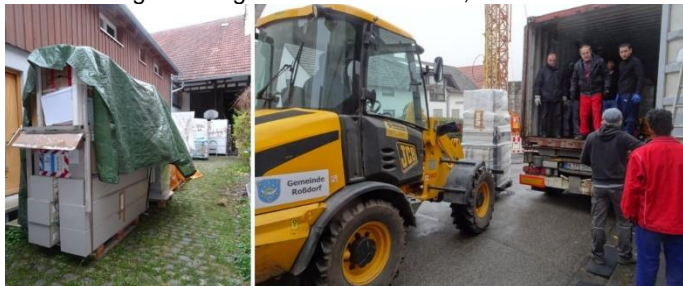
Bild: li. Palettenaufreihung mit vielen abgebauten PV-Modulen, re. Containerverladung mit Radlader-Unterstützung des Bauhofs am 19.11.2021, © REG.eV
